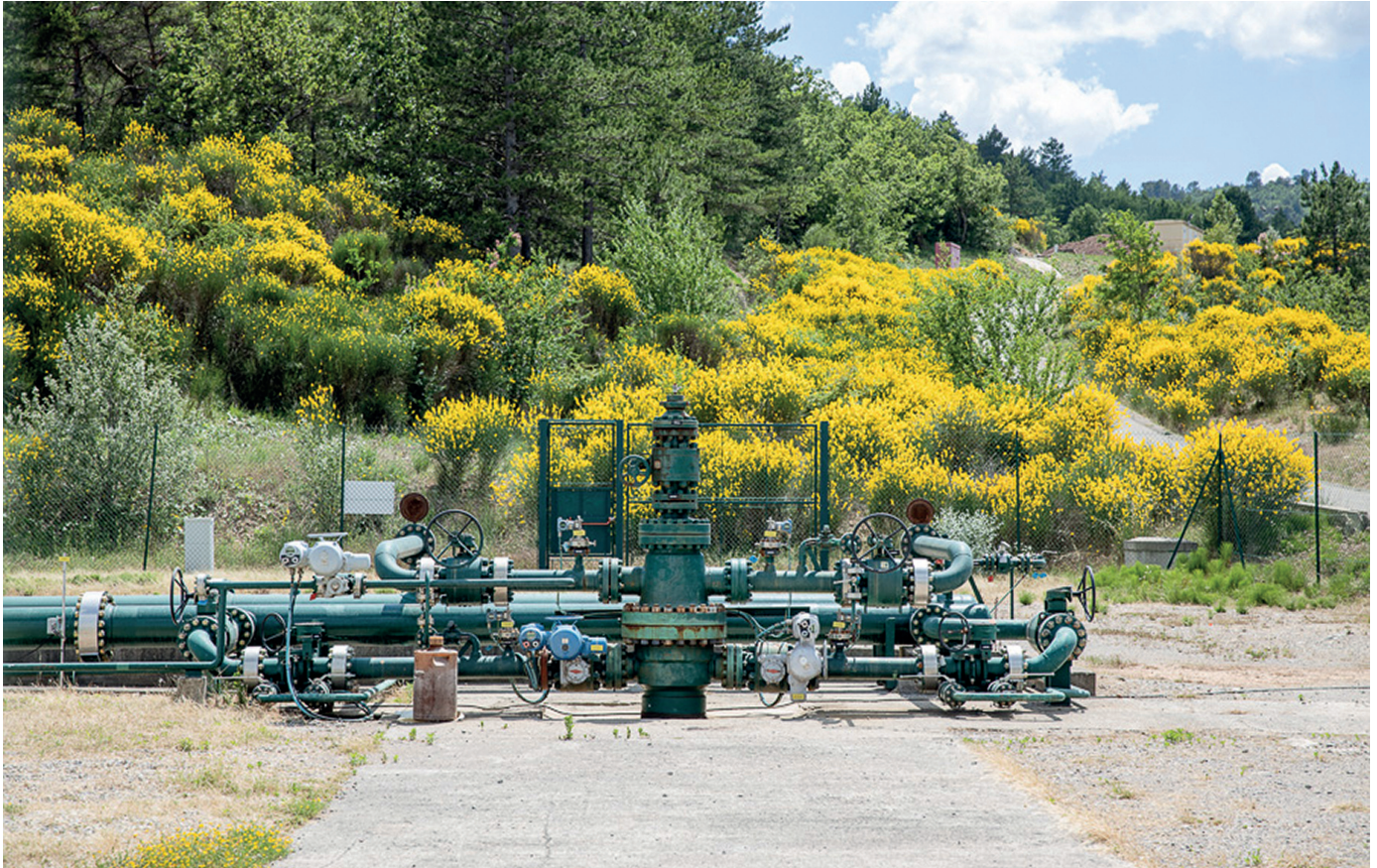
Installations de Géosel à Manosque.
