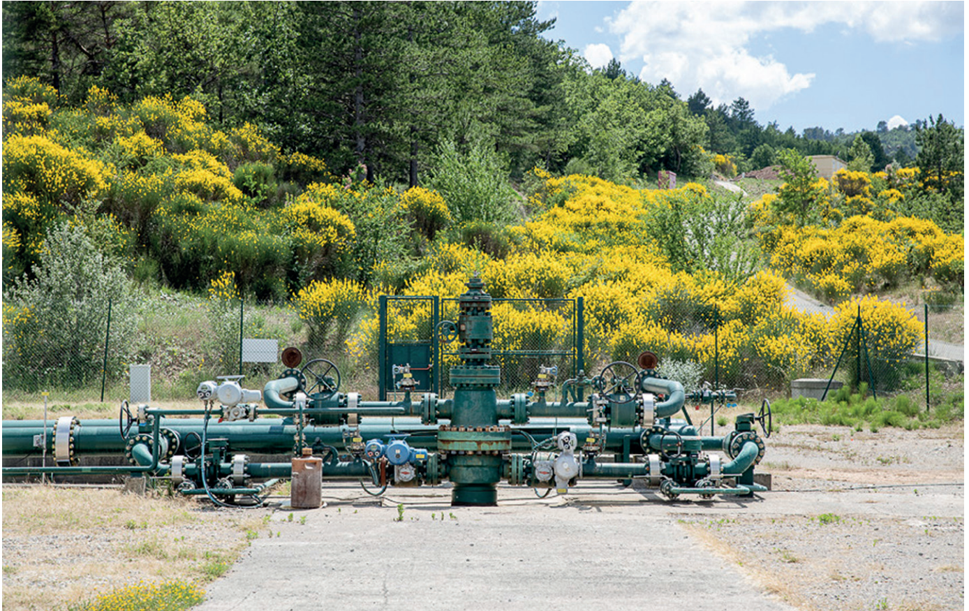
Installations de Géosel à Manosque.
