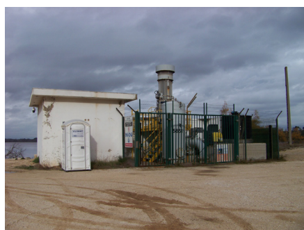
Station de relai de Géosel entre les deux étangs
